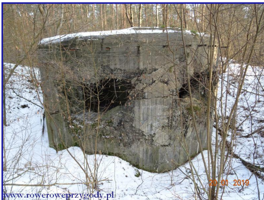
Zdjęcie nr 16 - Bunkier nr 10, posiadający podobne uszkodzenia jak poprzedni.
